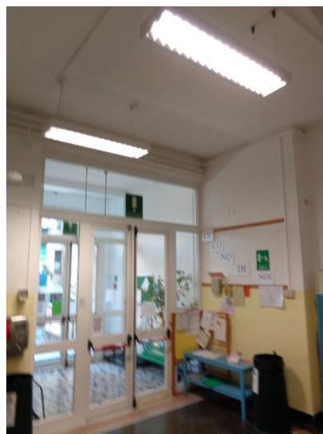
Figura 4.17 - Particolare dei corpi illuminanti ubicati nell’ingresso
