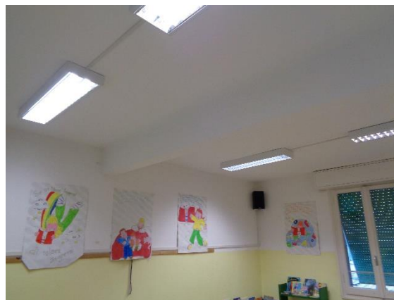
Figura 4.15 - Particolare dei corpi illuminanti ubicati nelle aule
