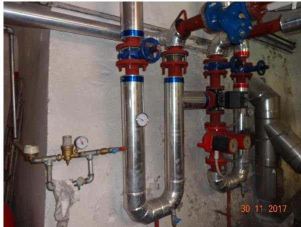
Figura 4.7 - Particolare della pompa di circolazione, valvola a 3 vie e lettura di temperatura
