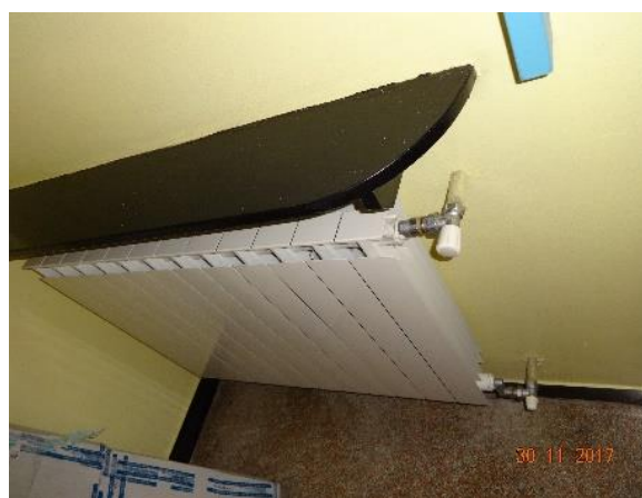
Figura 4.6 - Particolare installazione radiatori
