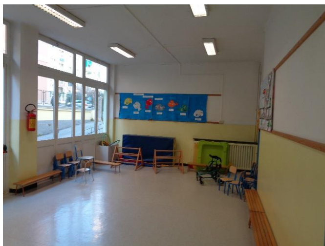
Figura 4.16 - Particolare dei corpi illuminanti ubicati nelle aule
