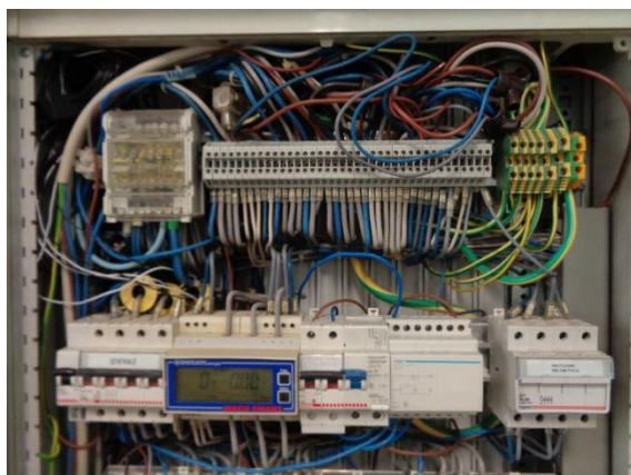
Figura 4.14 – Indagini diagnostiche quadri elettrici
