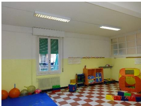
Figura 4.5 - Particolare installazione radiatori
